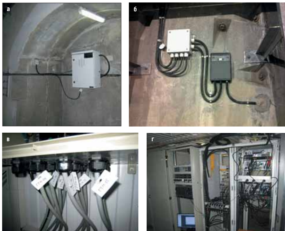
Рис. 2. Размещение и коммутация систем ГТМ в тоннелях трассы Адлер – Красная Поляна: а – внешний вид сейсмостанции, б – внешний вид блока регистрации и передачи информации аппаратуры ЕЭМИ, в, г – коммутация систем ГТМ
