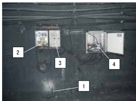
Рис. 3. Размещение оборудования системы геодинамической безопасности в тоннеле: 1 – трехкомпонентный сейсмодатчик; 2 – блок обработки сейсмомониторинга; 3 – блок обработки ЕИЭМПЗ; 4 – коммутационный шкаф
