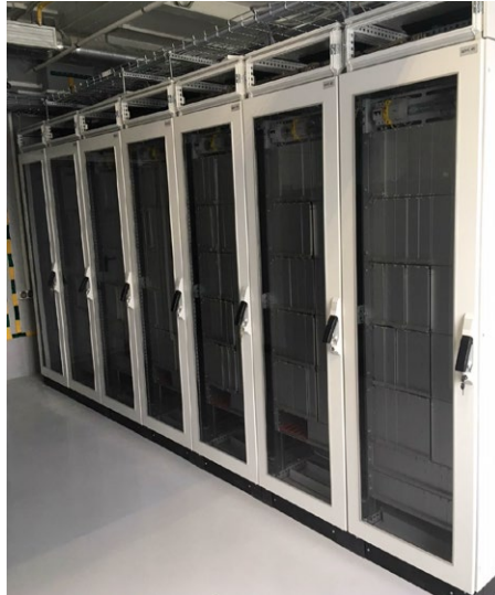
Рис. 4. Оборудование микропроцессорной централизации МПЦ-МПК, разработкой ЦКЖТ ПГУПС в аппаратной АТДП
